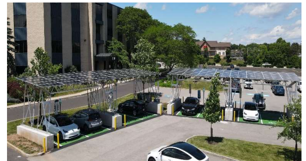
Solar & EVSE (PA)
